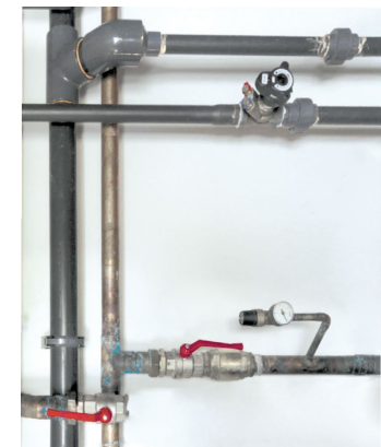
Exemple d'installation non calorifugée – source : Ademe –réussir un projet de qualité en géothermie de surface
